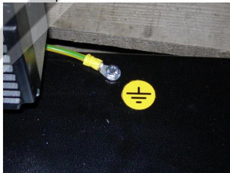
Generatoriaus įžeminimo vieta
