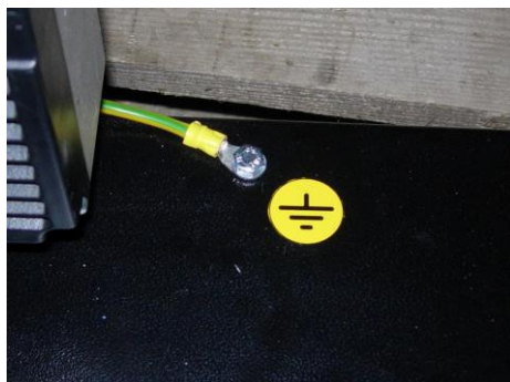
Generatoriaus įžeminimo vieta
